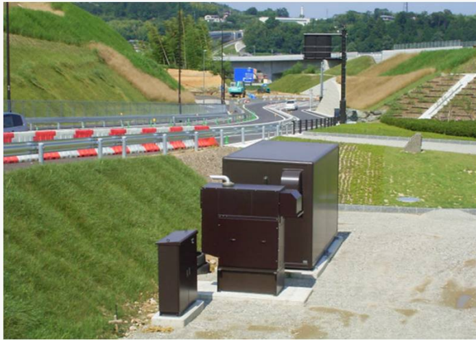
インターチェンジ用通信局舎 4700W×2300D×2700H (YC206)
