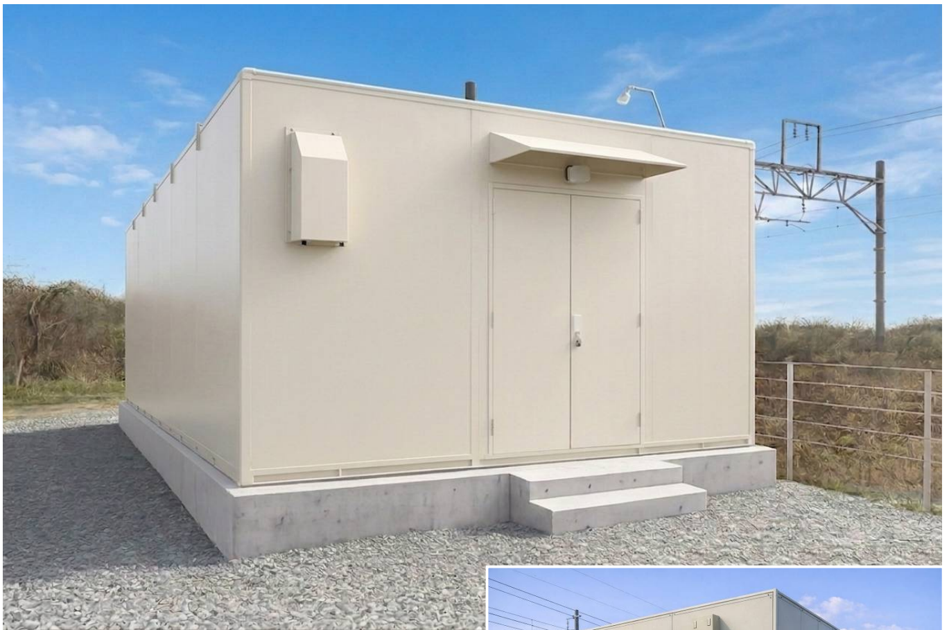
※継電連動機 連動・閉そくユニット大型収容箱
