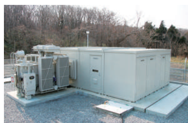
14 受変電設備用
