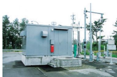
15 高速道路用 （スマートIC管理施設）
