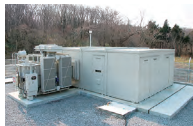
14 受変電設備用
