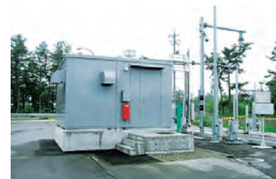
15 高速道路用 （スマートIC管理施設）
