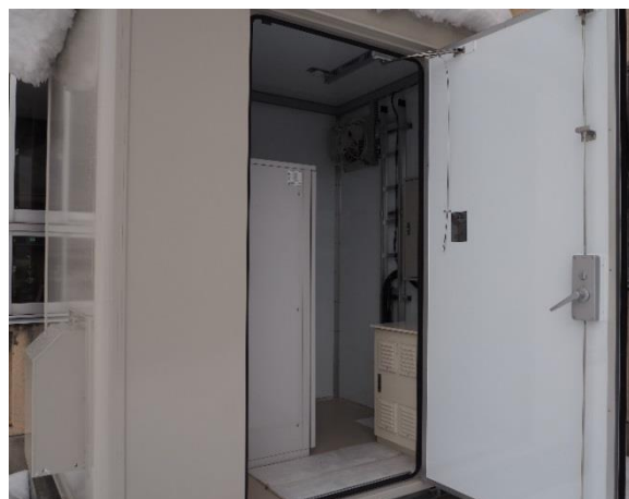
室内(蓄電システム収納例)
